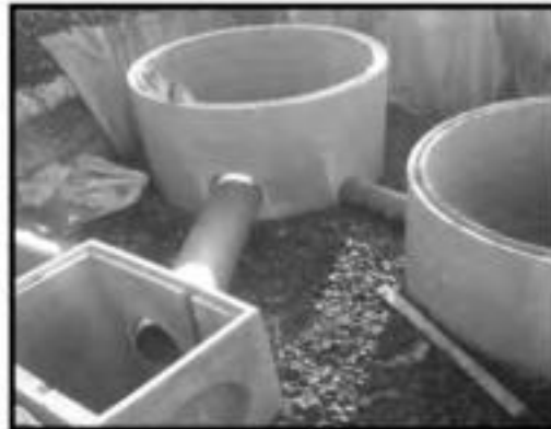
Infiltration des eaux pluviales de la rue H. Raoult à Fêchain
