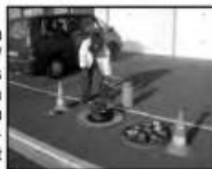
Test à la fumée à DOUAI
